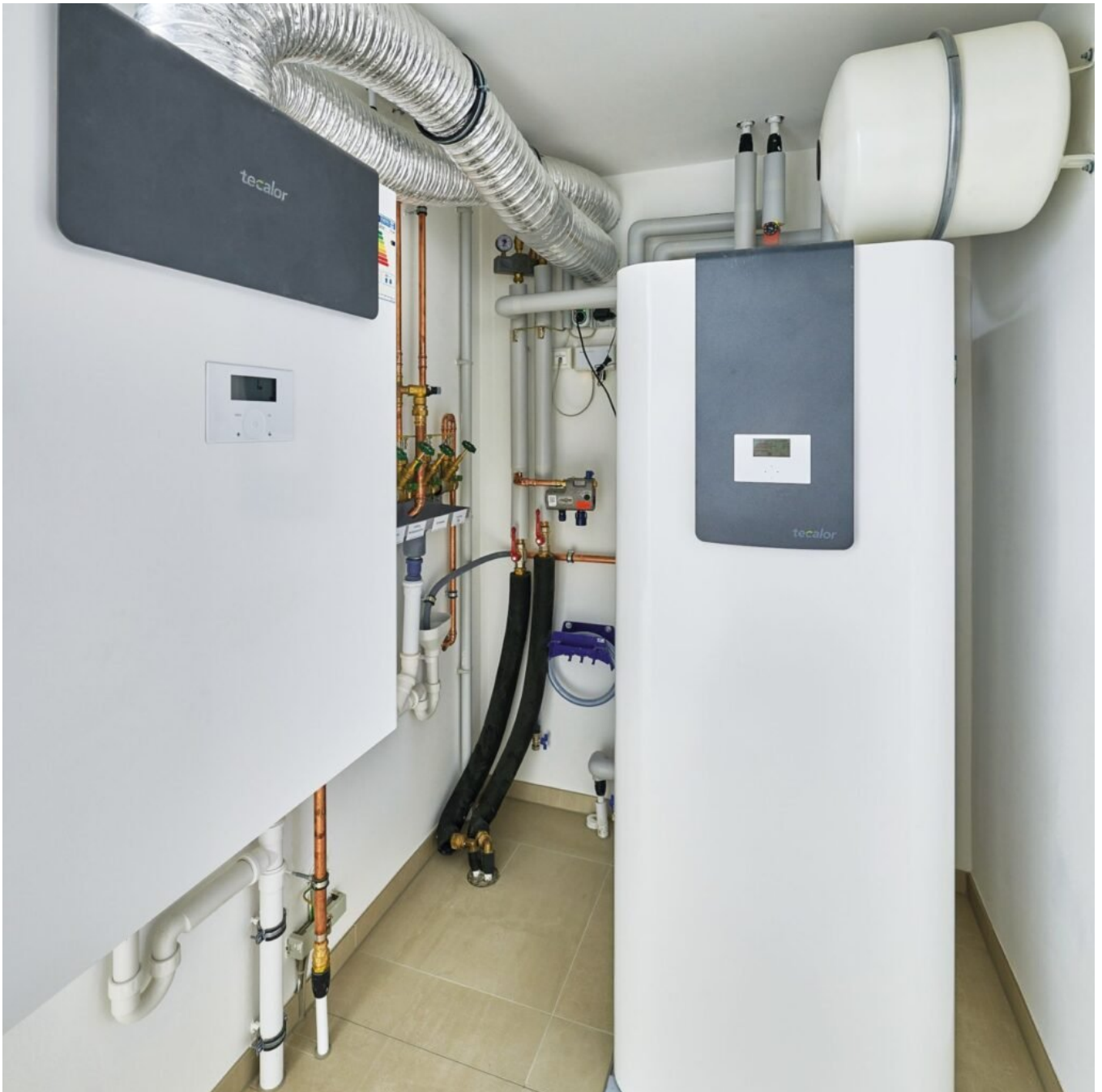
Die Haustechnik umfasst Heizen, Lüften und Warmwasserbereitung. Foto: Fertighaus WEISS
