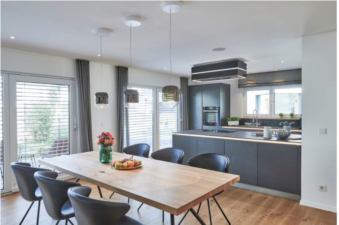
Die kontrollierte Wohnraumlüftung mit Wärmerückgewinnung sorgt jederzeit für gutes Raumklima. Foto: Fertighaus WEISS
