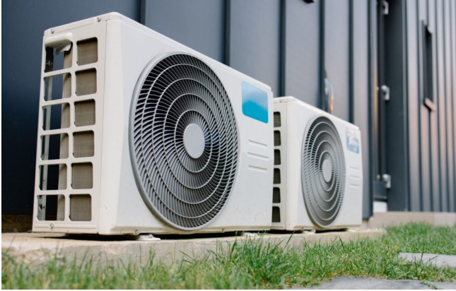
Klimaanlagen im Doppelpack zur effizienten Kühlung größerer Gebäude. Foto: doralinsamuel/www.elements.envato.com
